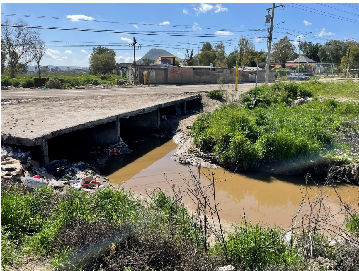
Figura 28. Imagen de contexto de márgenes antes de caída en embovedado de Calle del Abedul en el PM02_AP_FAUNA, de aguas arriba a aguas abajo.
