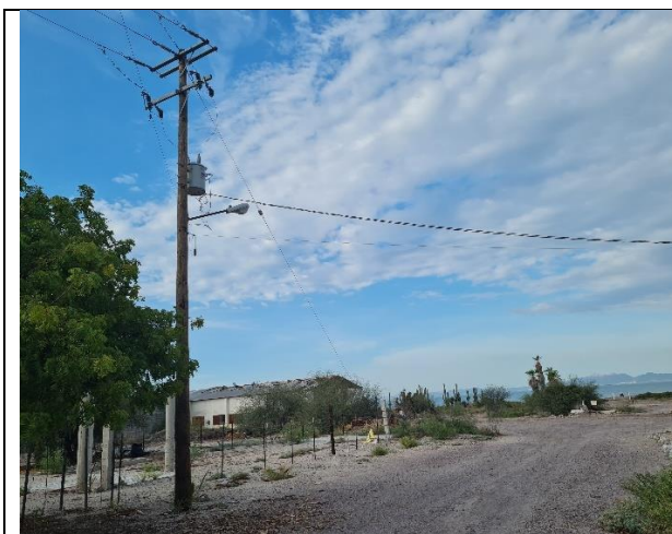
Servicio de electricidad colindante al predio
