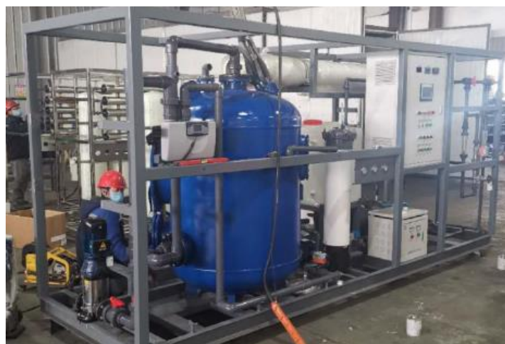
Ilustración 2 Ensamble de los componentes que integran la planta desaladora de 20 m3 día
