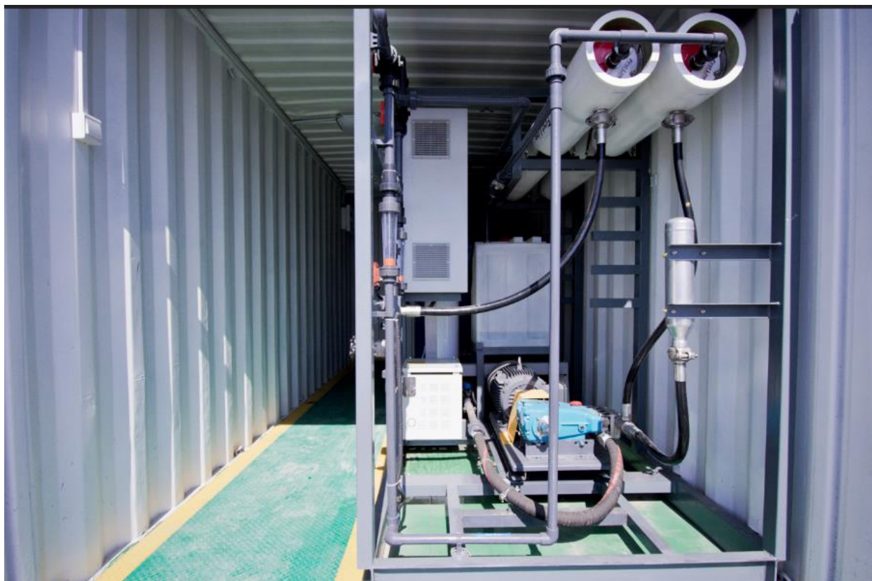
Ilustración 3 Vista frontal del Skid donde se montan los componentes de la planta desaladora
