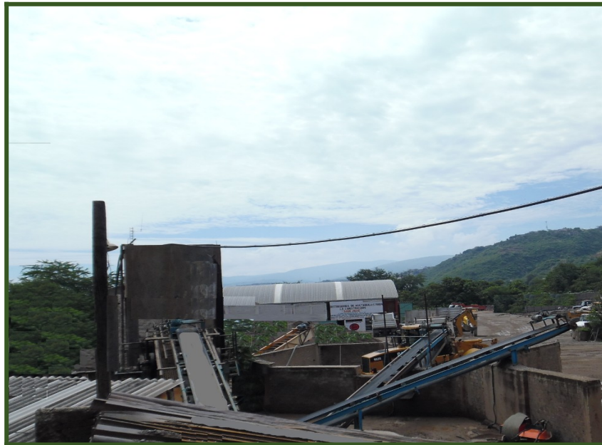
Foto 5. Vista de la planta de cribado, donde se encuentra instalada, esperando los permisos pertinentes para su operación.
