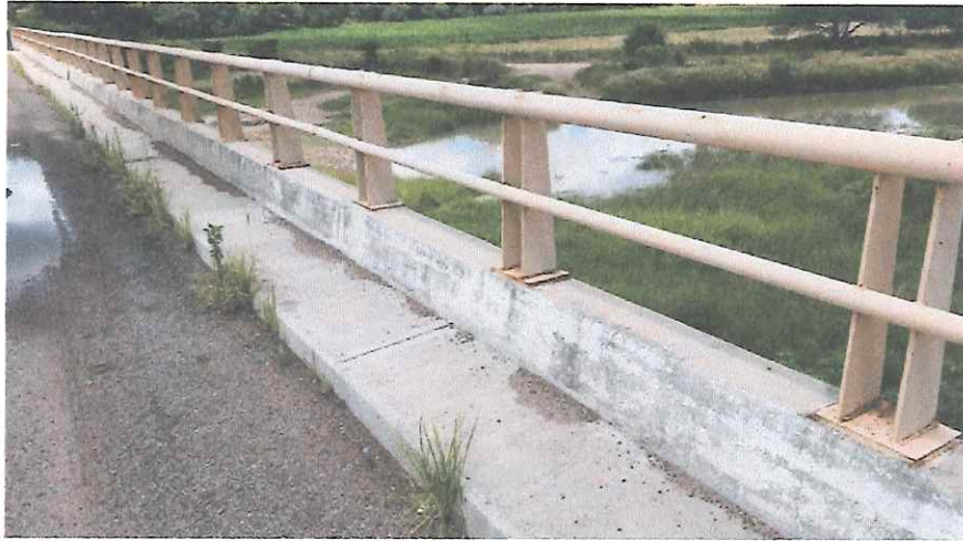
Figura. 14. Falta de limpieza genera y pintura a barandales.
