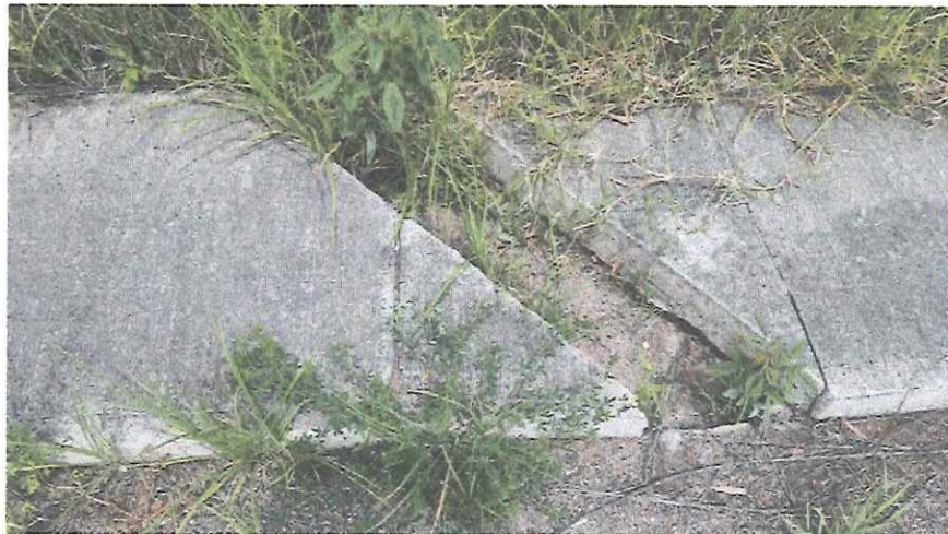
Figura. 13. Falta de construcción de lavadero, limpieza general requerida.
