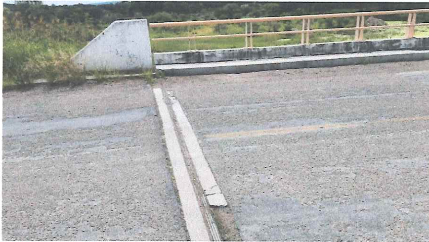
Figura. 12. Desgaste de juntas constructivas.
