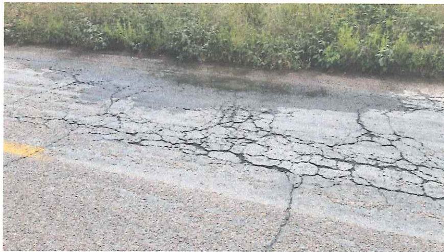
Figura. 16. Ejemplo de hundimiento del abroche en el puente Juiquinaque.
