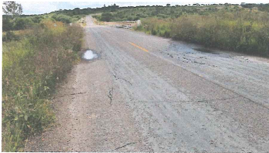
Figura. 11. Ábroches con hundimientos.
