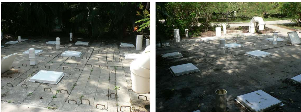
FIGURA II. 16 PLANTA DE TRATAMIENTO EN OPERACIÓN
