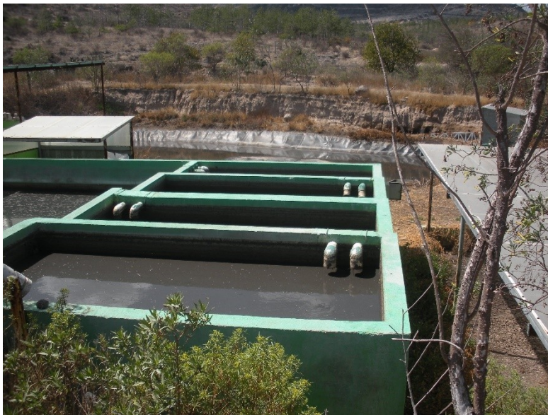
Figura 24. Planta de tratamiento de aguas residuales.
