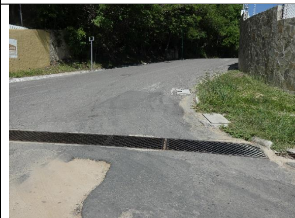
Rejillas de encauzamiento del agua pluvial en calles.
