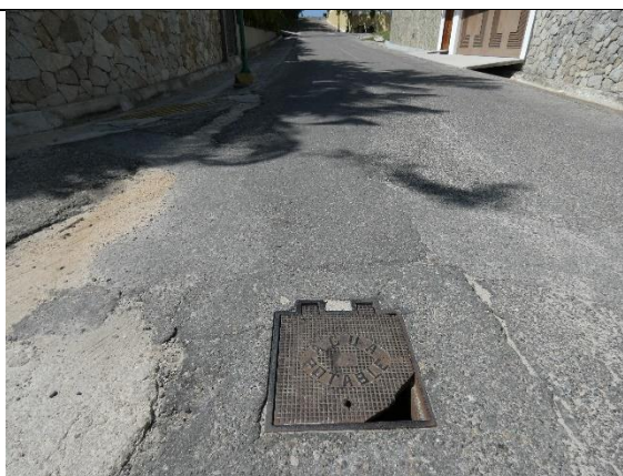
Existencia de agua potable.
