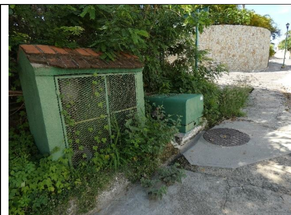
Existencia de energia electrica subterranea.
