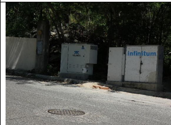
Existencia de servicios de telefonia e internet.
