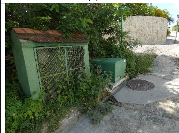
Existencia de energia electrica subterranea.
