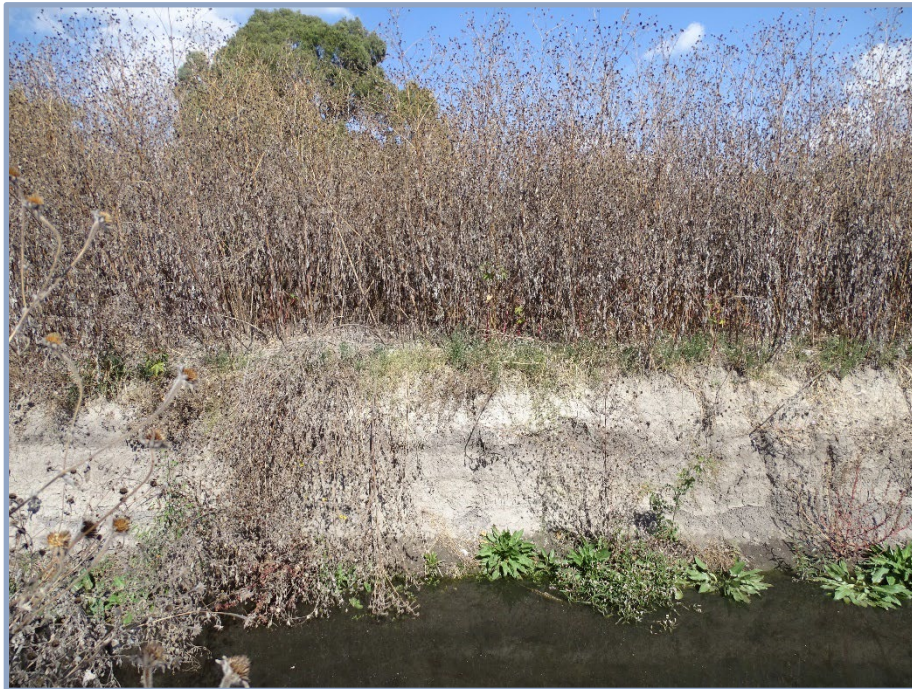
A-103 Lav 3 Descarga pluvial
