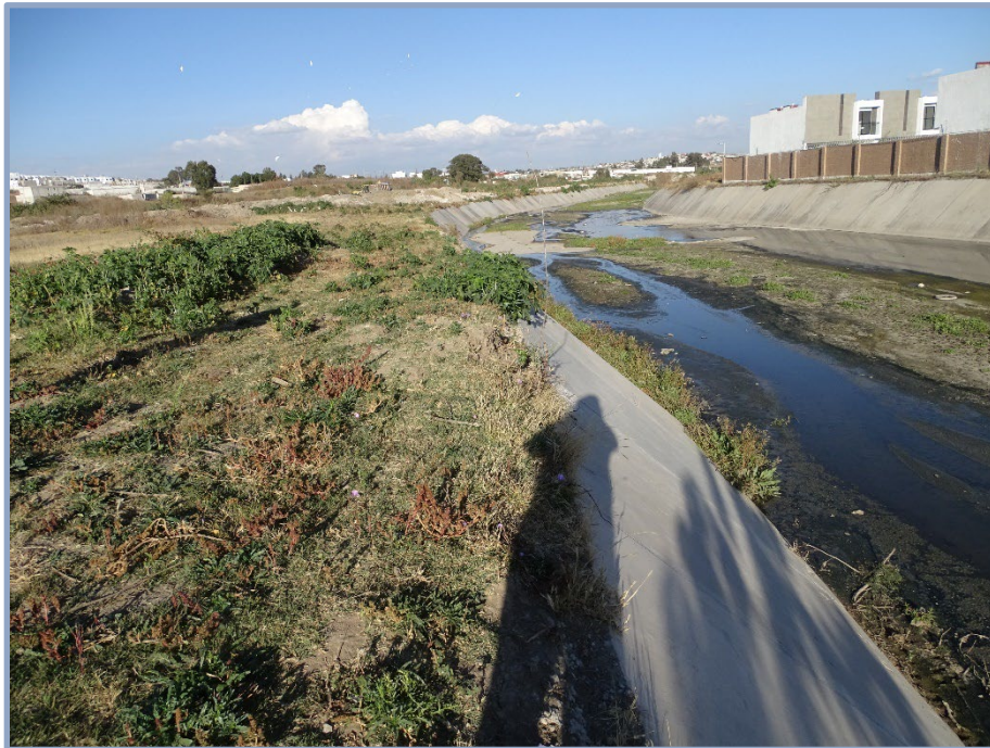
V-126 Descarga pluvial
