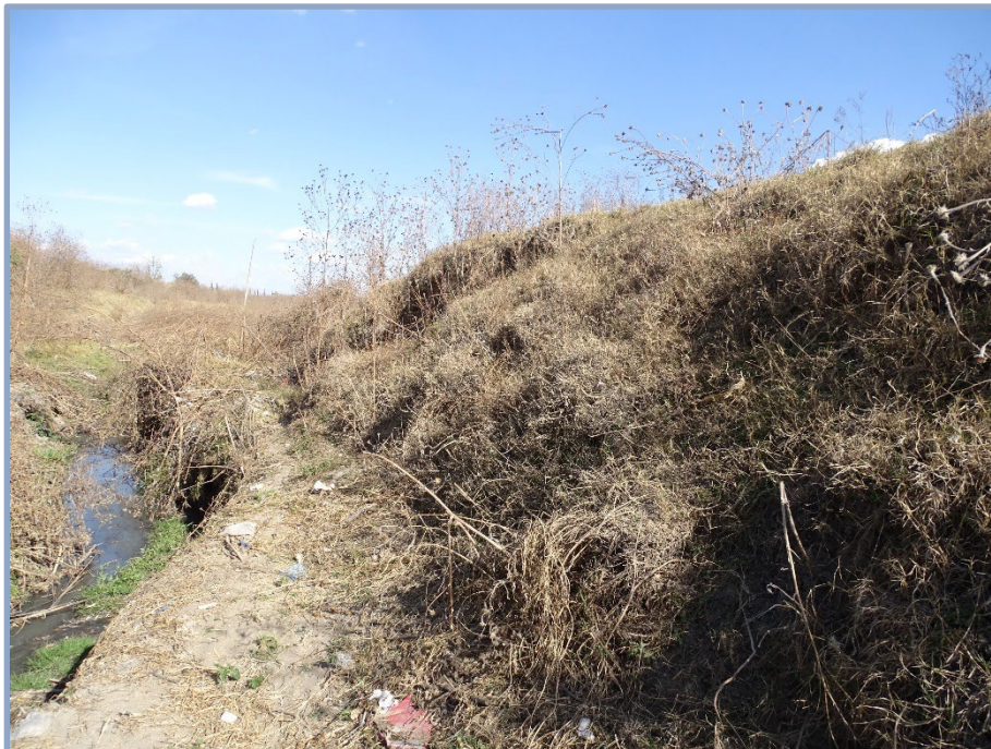
A-106 Lav 5 Descarga pluvial
