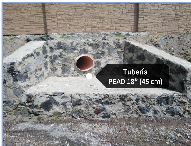
Figura No. 7 Ejemplo de Descarga pluvial con tubería.
