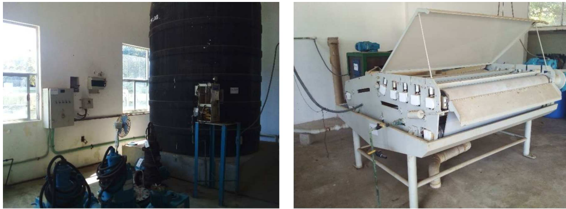
Figura 4. Se muestra el área de tratamiento y almacenamiento temporal de los lodos secos (silo y prensa).
