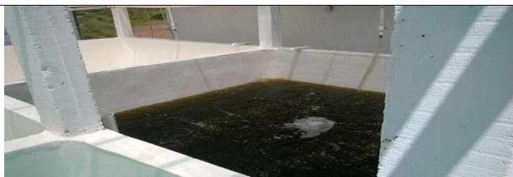
Área de tanques masivos.
