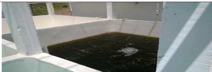
Área de tanques masivos.
