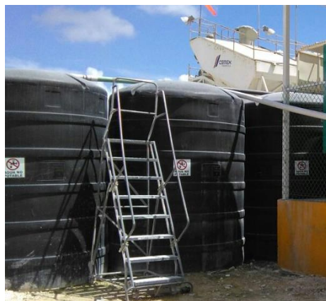
Figura II.5. Ejemplo del almacenamiento de agua.
