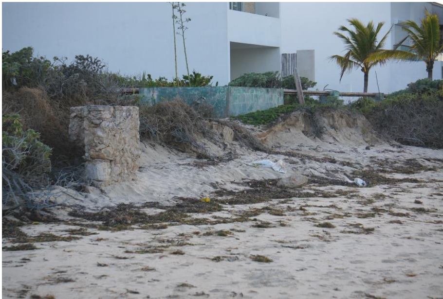
4.5. Obras que se están realizando dentro de la primera duna, sin un sistema elevado de pilotes y en donde la vegetación nativa se ha eliminado.
