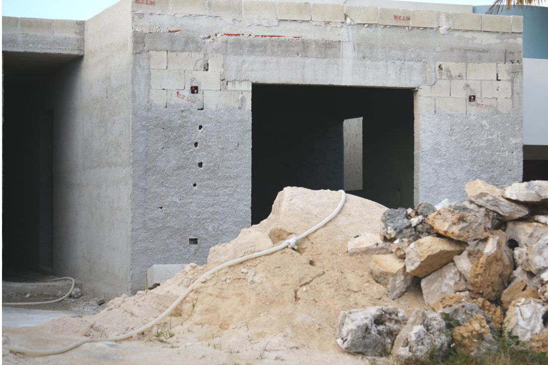
Fig. 4.3. Obra en construcción a escasos metros del predio, realizada sin pilotes y a escasos metros de cuerpo de agua, por lo que ni los inmuebles federales se respetaron.
