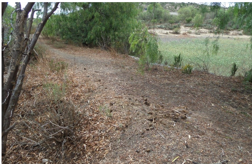
Ilustración 21. Condiciones en las que se encuentra el muro de contención
