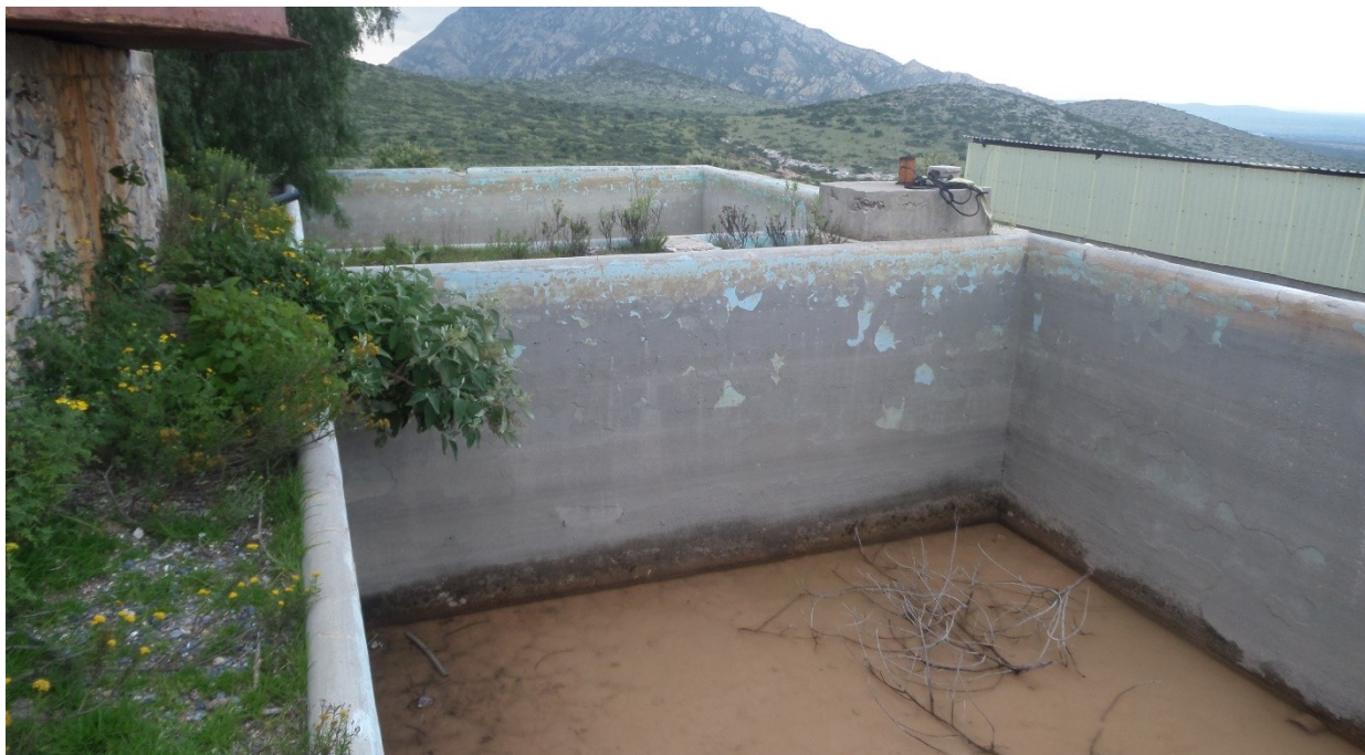
Ilustración 13.- Área de piletas para recuperación de agua
