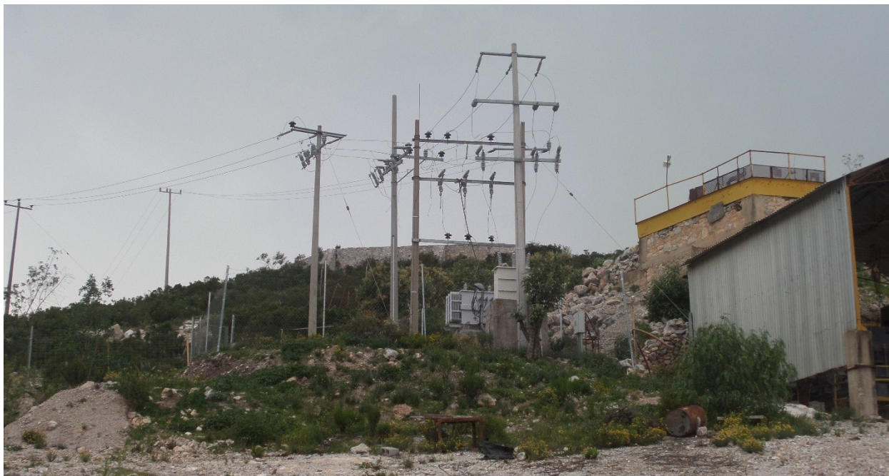
Ilustración 5.- Panorámica de la subestación eléctrica de la planta de beneficio a rehabilitar.
