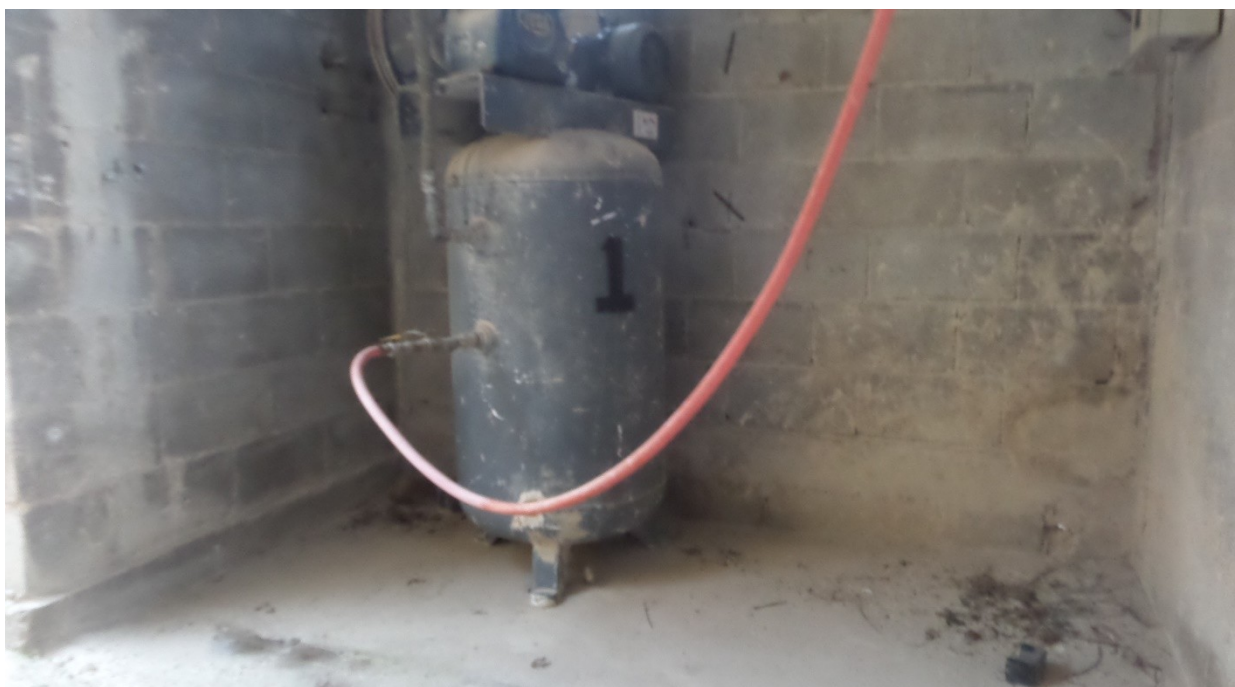
Ilustración 14.- Cuarto de compresor
