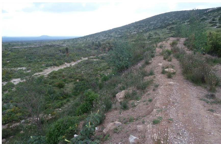
Ilustración 22. Condiciones en las que se encuentra el muro de contención de las aguas de contacto
