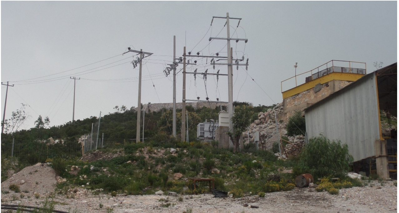
Ilustración 9.- Subestación eléctrica de la planta de beneficio
