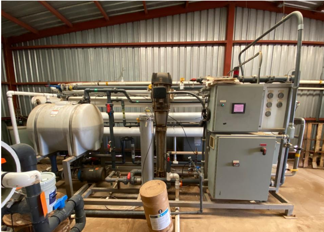
Foto 5. Equipo de osmosis inversa instalado en el interior de la nave.
