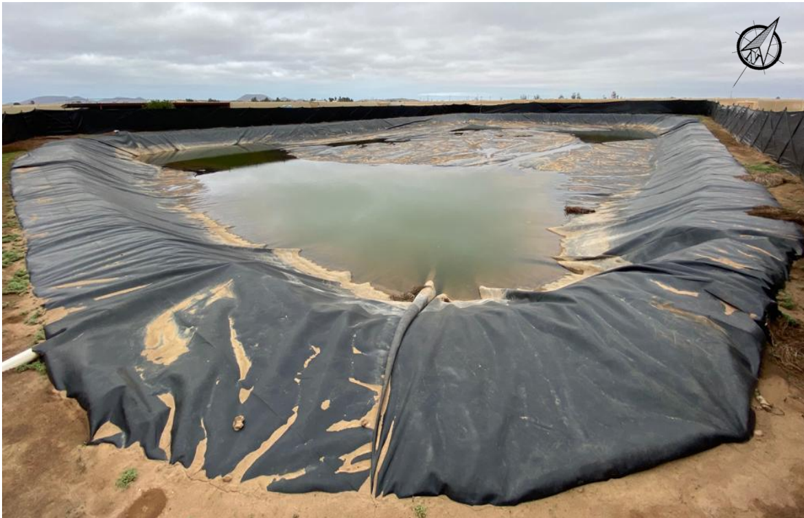
Foto 8. Reservorio que recibirá el agua del pozo para alimentar a la desaladora.
