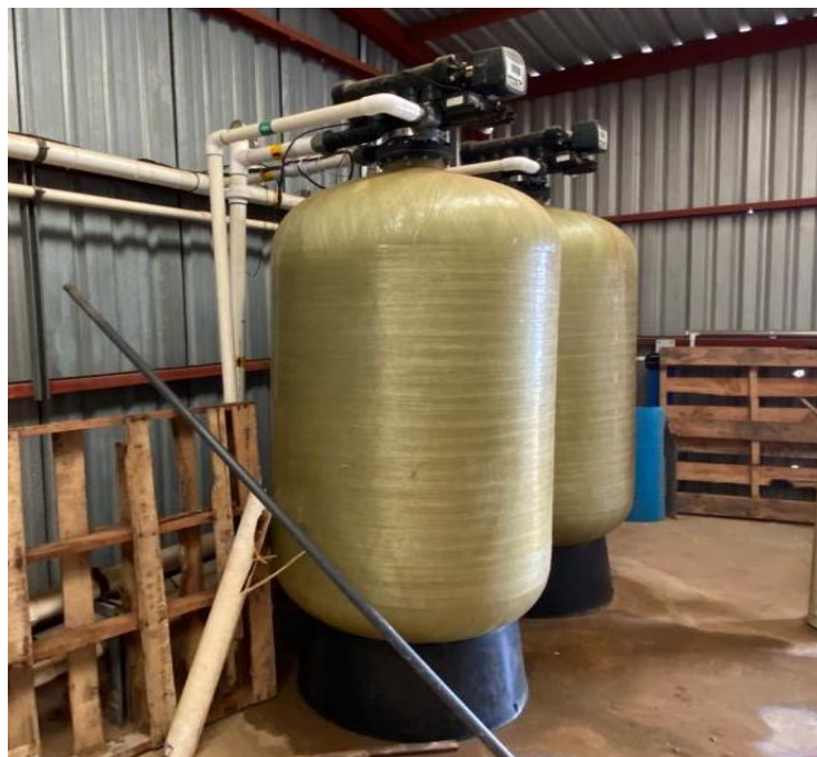
Foto 6. Filtros de arena utilizados para la retención de sólidos suspendidos mayores a 15 micras.
