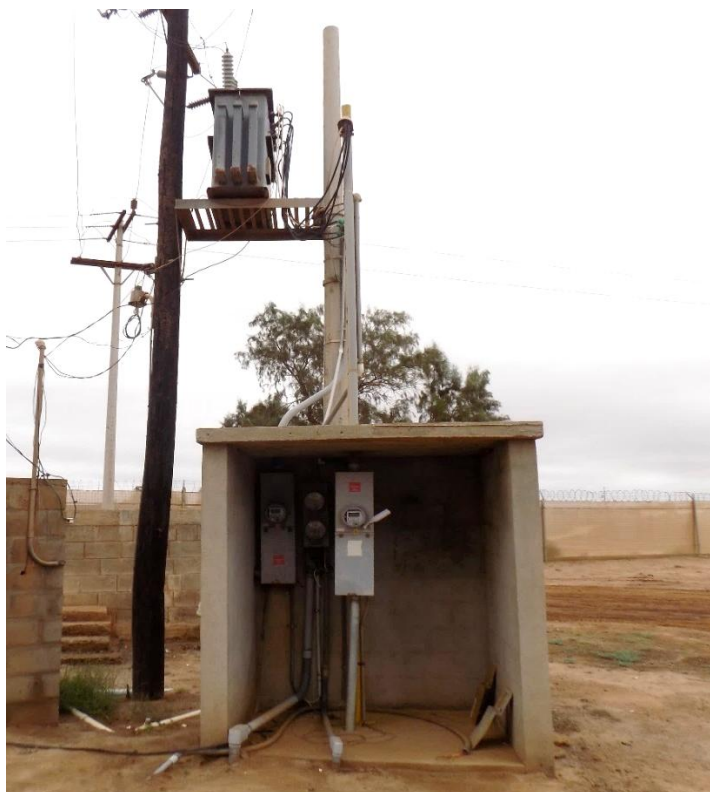
Foto 10. Vista actual de la subestación eléctrica de 150 KVA.
