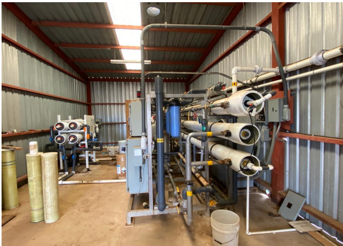
Foto 4. Banco de membranas instalado en el interior de la nave.
