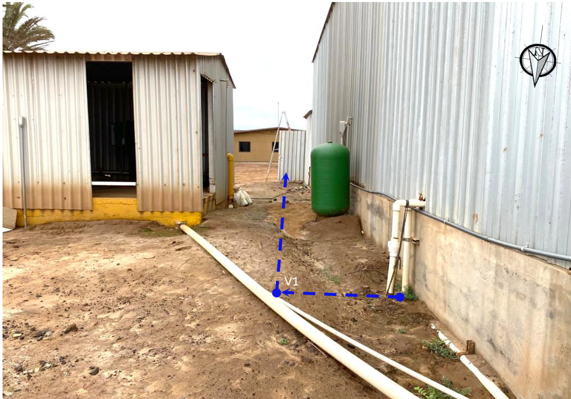
Foto 14. Vista del inicio de la tubería de conducción del agua de rechazo a partir de la planta desaladora.
