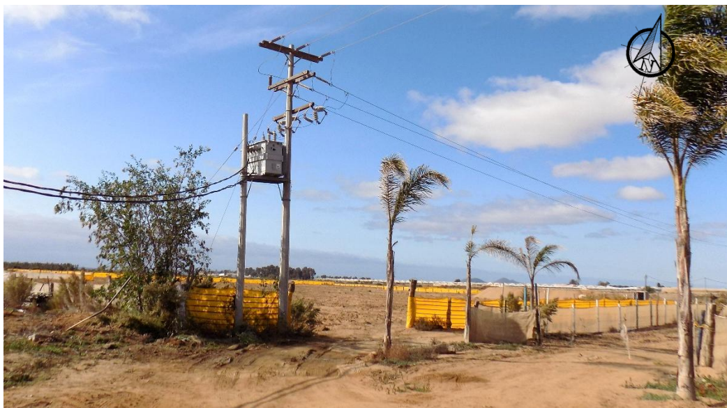
Foto 5. Subestación eléctrica de 300 KVA que alimentará a la planta desaladora, ubicada a orillas de la parcela 93 Z-1 P1/1 Fracc. del Ejido Nueva Odisea.
