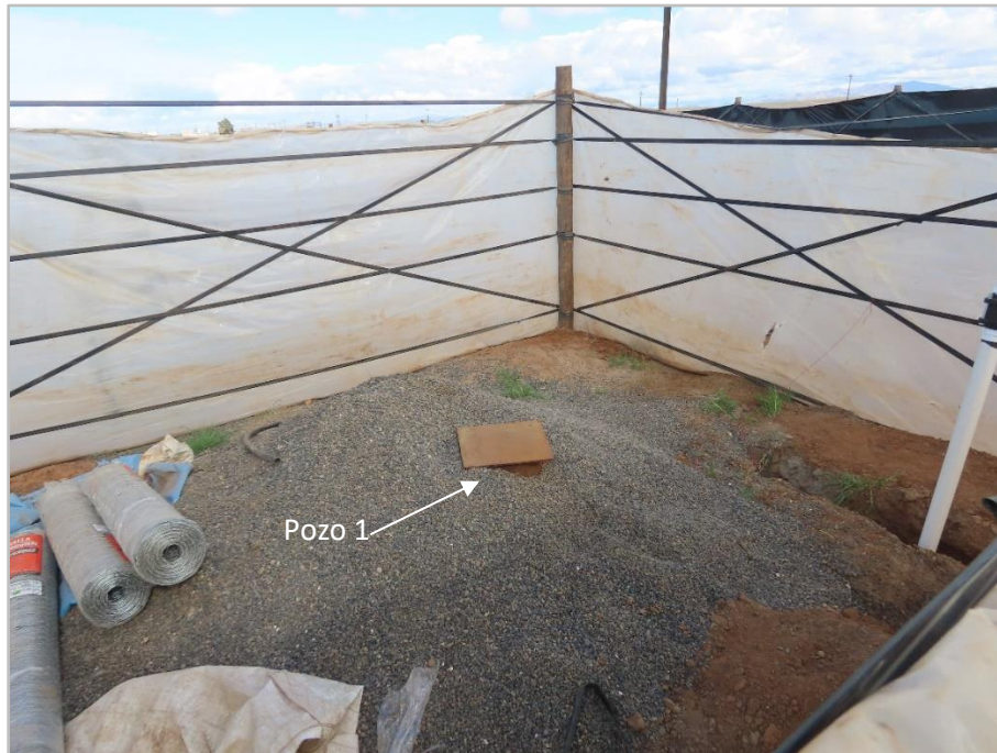
Foto 1. Pozo agrícola 1 con título de concesión O1BCA100116/01AQOC08. El pozo ya está perforado únicamente falta instalarle la bomba de extracción.
