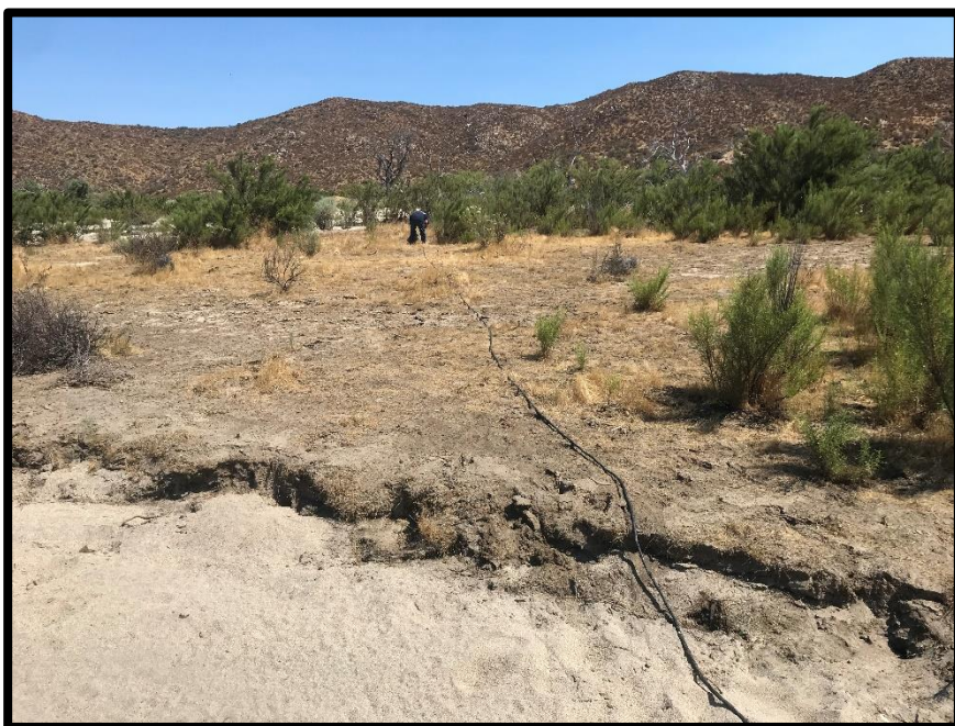
Foto 28. Detalle del tendido de cable para adquisición de datos de la línea 8.
