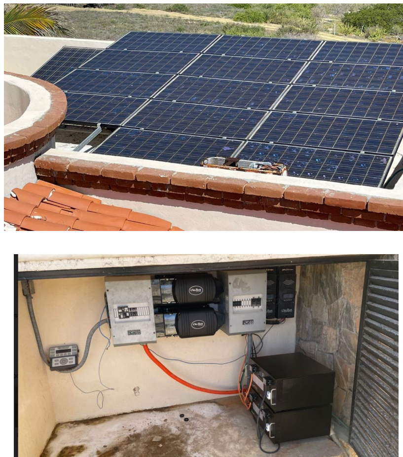
Figura 9. Paneles solares y centro de carga operante en la casa habitación
