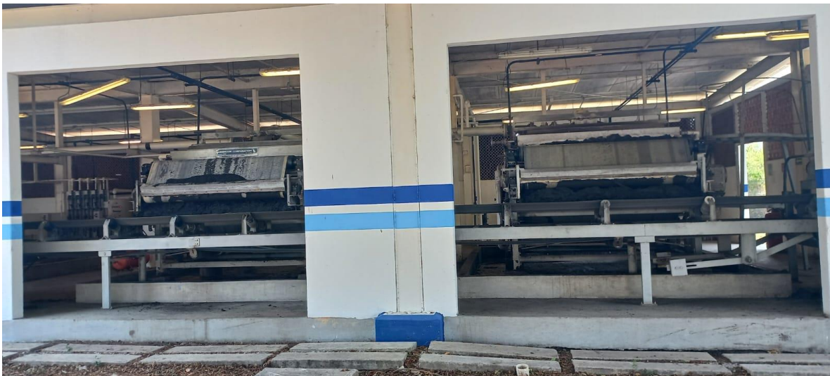
Foto 8.- Filtros banda: se lleva a cabo el deshidratado de lodos provenientes del digestor anaerobio mediante la adición de polímero catiónico el cual promueve la separación del lodo y el agua por la formación de floc y presión mecánica.
