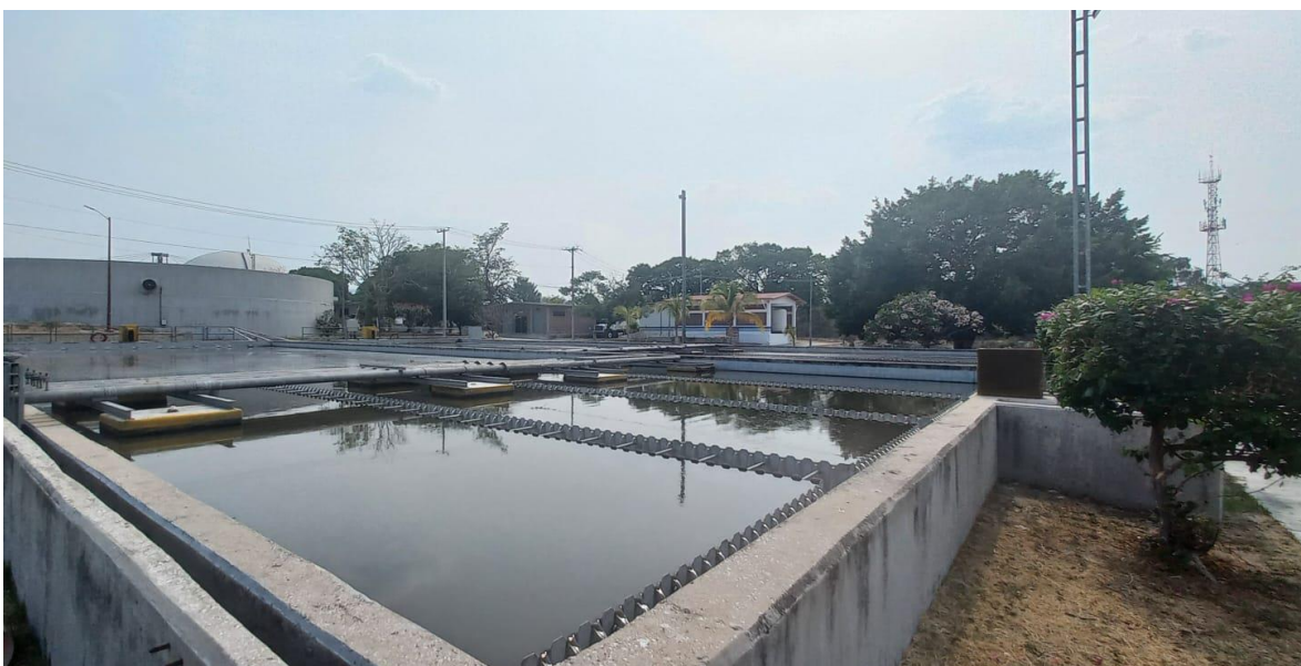
Foto 2.- Clarificador secundario: permiten la separación por gravedad de los SST (sólidos suspendidos torales) generados en el proceso del tratamiento del agua.
