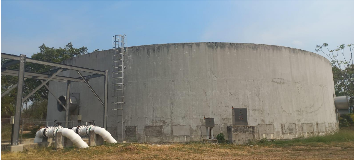
Foto 3.- Filtro percolador: se lleva a cabo el proceso de absorción y oxidación biológica de la materia orgánica mediante la filtración del agua residual con flujo descendente (efecto de percolación).
