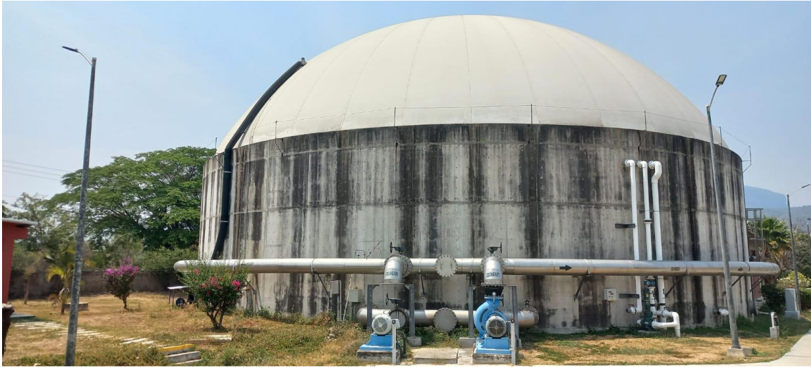
Foto 7.- Digestor anaerobio: se lleva a cabo la digestión de los lodos producto del tratamiento de las aguas residuales, la digestión anaerobia se lleva a cabo en ausencia de oxígeno (condiciones anaerobias) la cual permite la degradación de toda la materia orgánica transformando la mayor parte en metano (biogás).
