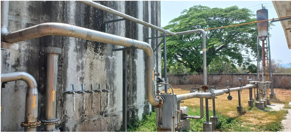
Foto 9.- Quemador de biogás: el metano (biogás), generado durante el proceso de digestión anaerobia de la materia orgánica, se elimina mediante un proceso de combustión asistida en el quemador de biogás.
