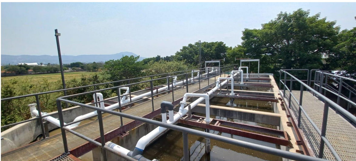
Foto 5.- Desarenadores: promueve la separación de la materia orgánica de las arenas, la extracción de las arenas sedimentadas se lleva a cabo mediante un sistema de air-lift y un clasificador/lavador de arenas tipo tornillo.
