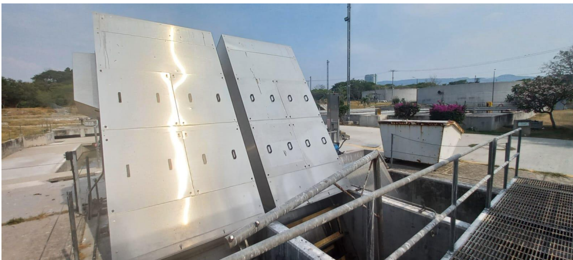
Foto 1.- Cribas gruesas: tienen como objetivo captar los sólidos de tamaño mayor a 6 mm y separar dichos sólidos del agua residual que entra a la PTAR.
