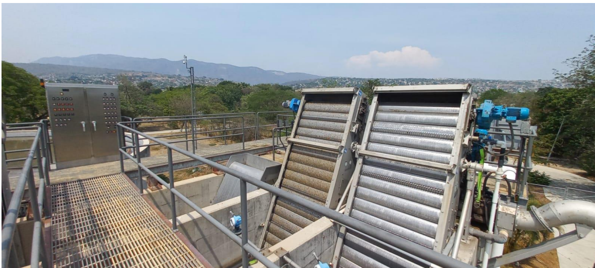
Foto 4.- Cribas finas: tienen como objetivo retener los sólidos mayores a 3 mm presentes en el agua residual.
