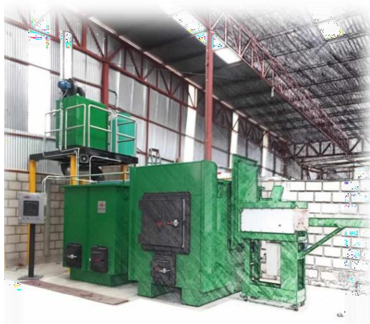
Figura II.5 Vista general del Incinerador marca INCIMEX modelo UMCC-1T-RPBIs-250
