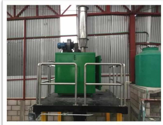
Figura II.11 Sistema de inducción del Incinerador marca INCIMEX modelo UMCC-1T-RPBIs-250
