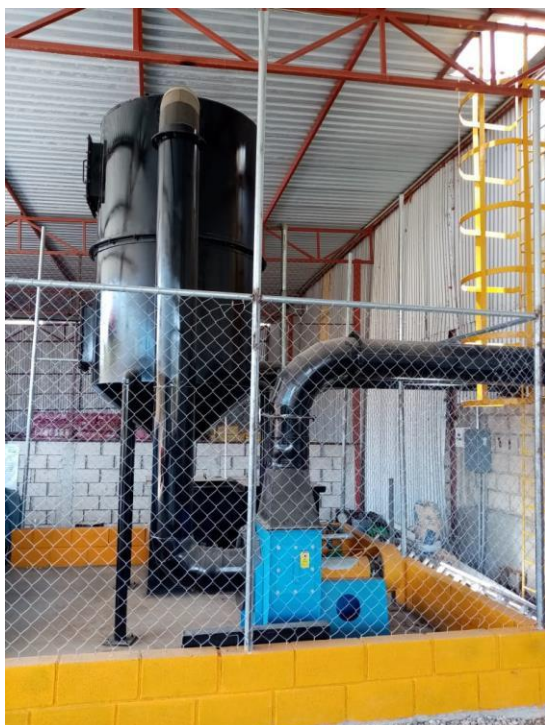
Figura II.14 Sistema de control de emisiones del incinerador marca INCIMEX
