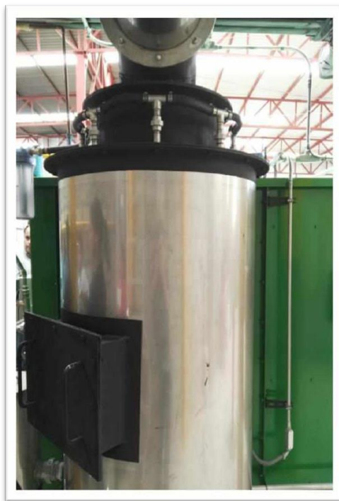
Figura II.10 Unidad de enfriamiento y retención de partículas del Incinerador marca INCIMEX modelo UMCC-1T-RPBIs-250
