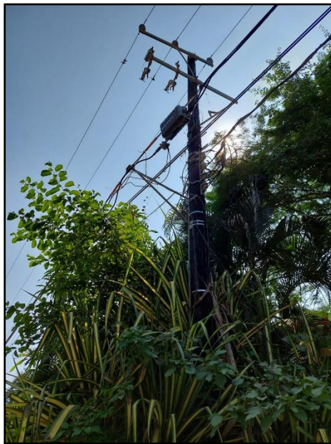
Ilustración VIII.3.1. Servicios de electrificación de la CFE del proyecto “Casa Benham”.
