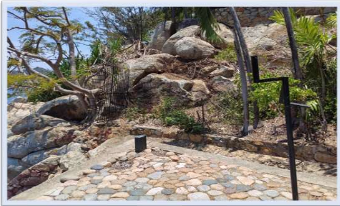
Ilustración 9. Zona donde se observa los restos de la compuerta que se encontraba anteriormente.
