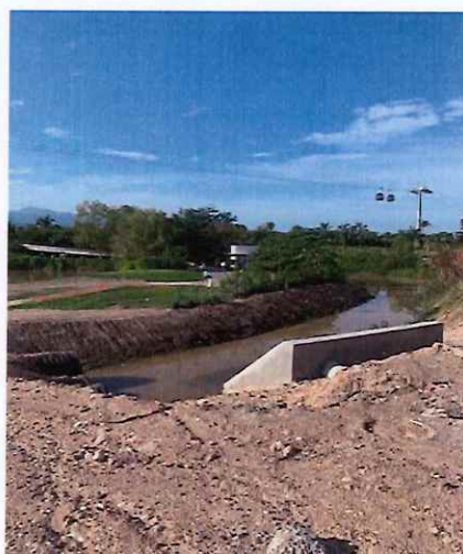
IMAGEN I. 34- INFRAESTRUCTURA RED DE AGUAS PLUVIALES
