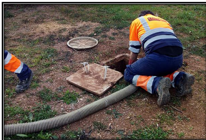
Figura VI. 1 Ejemplo de mantenimiento de fosa séptica
