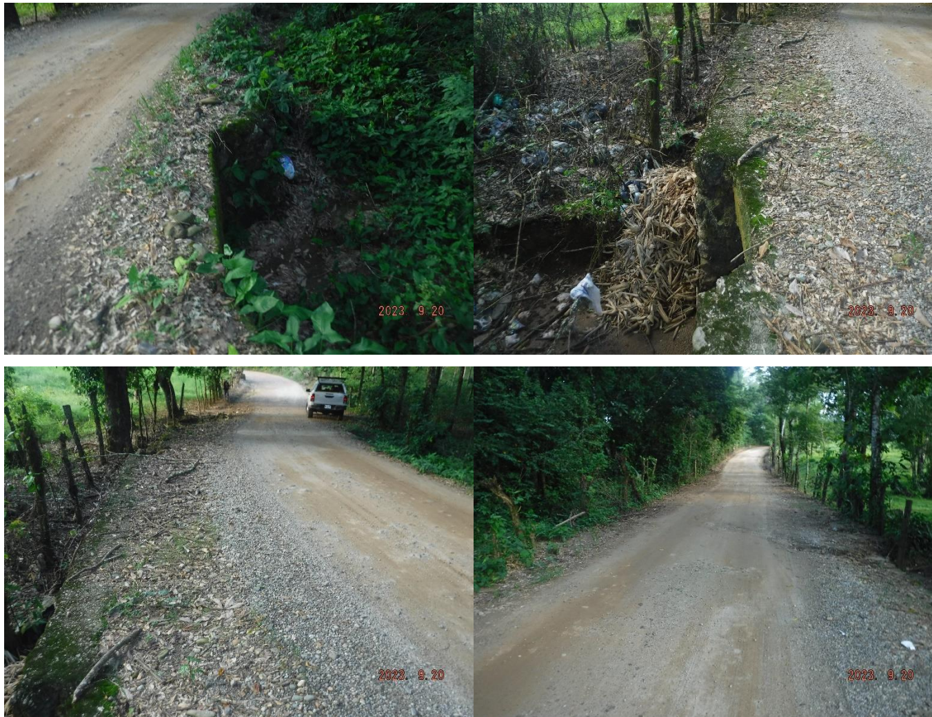
Foto 17 a la 20: Condiciones actuales del km 1+940, los usos de sus colindancias, se presenta un alcantarillado pluvial.
