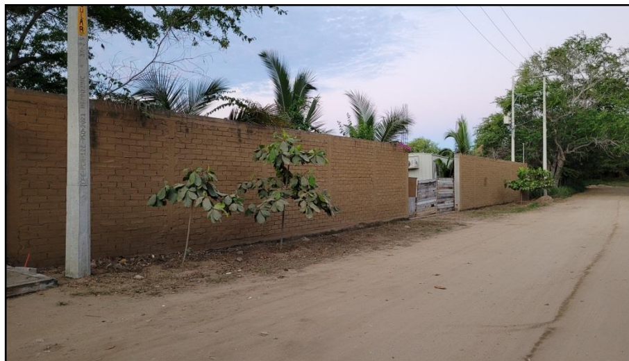
Imagen 107 Postes que integran la red eléctrica que brinda el servicio a las instalaciones ubicadas en la playa Bacocho
