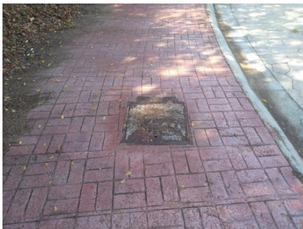
Caja de válvulas del sistema de agua potable
