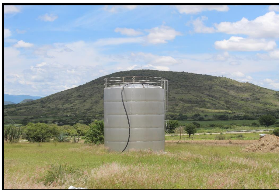
Figura II.13. Tanque de agua potable.
