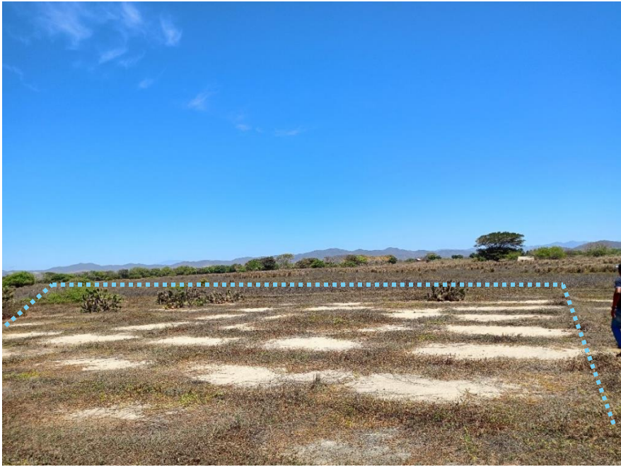
Imagen II.7.-Estado actual de la plancha de concreto, obsérvese que con el transcurso de los años este material de concreto se encuentra deteriorado por la presencia de sales.
