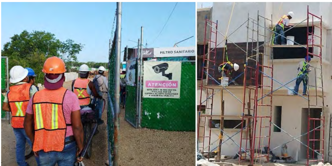
Figura 18. Ejemplo estación de agua purificada instalada en obra.
