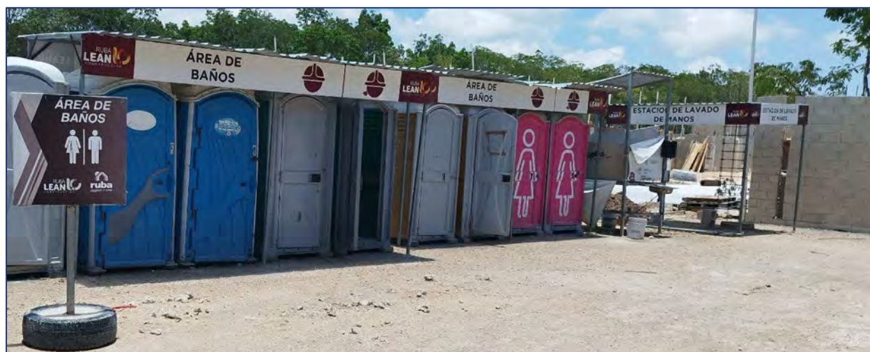
Figura 15. Ejemplo de sanitarios instalados en obra, con estación de lavado de manos.
