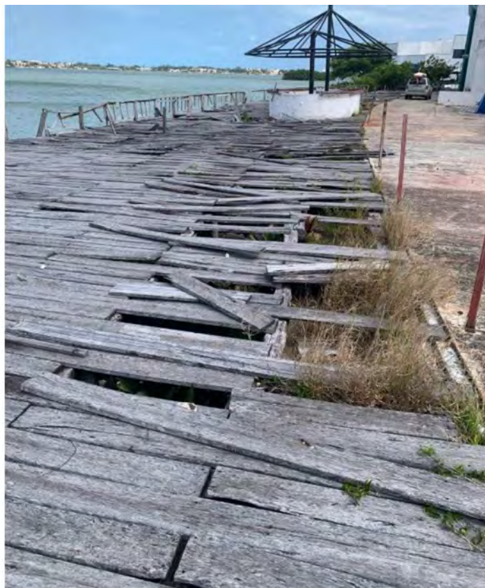
Figura II:3. Deterioro del Deck de madera que será remodelado.
