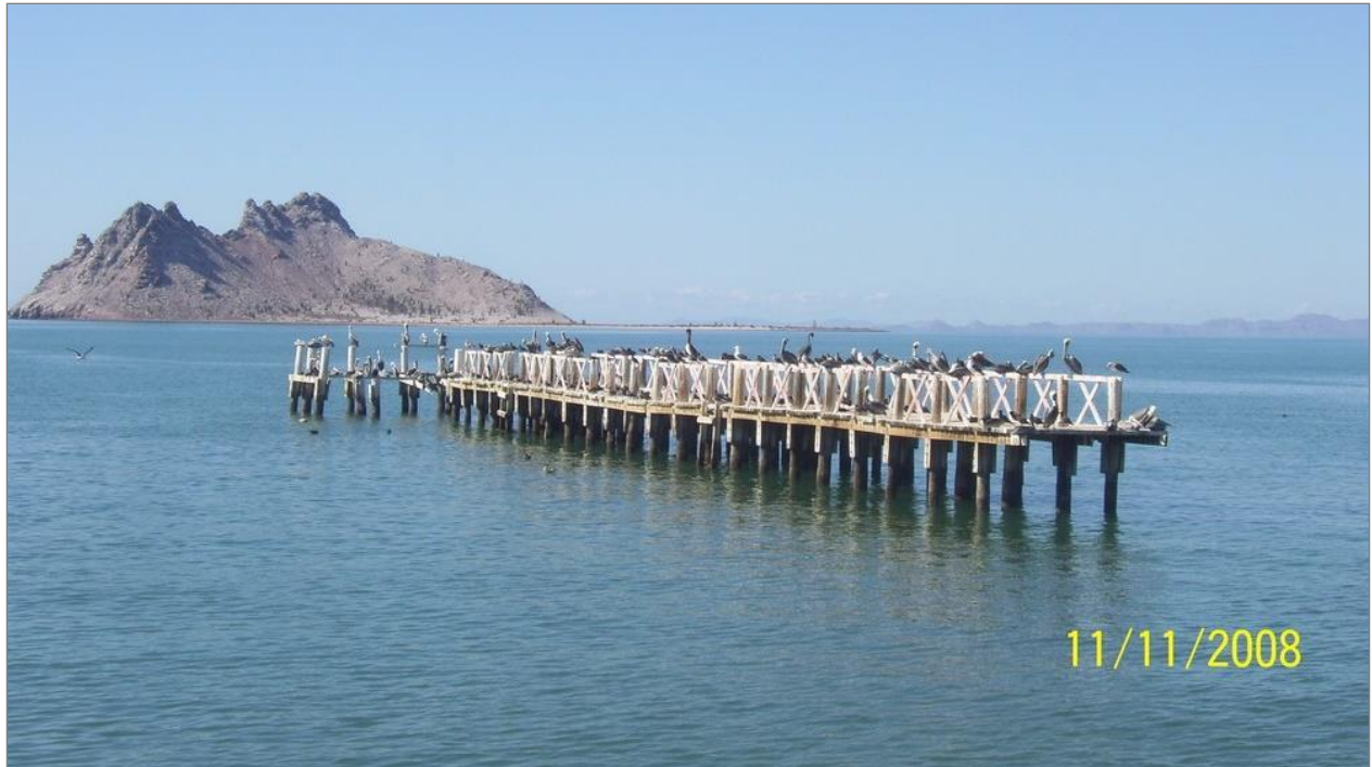
Figura 2. Fotografía del muelle de Bahía Kino afectado por el paso del huracán “Henriette” en el año 2007.
