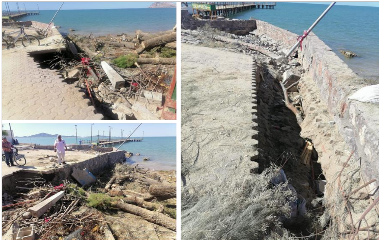
Figura 5. Fotografías de los daños ocasionados por el huracán “Hilary” en agosto de 2023 sobre la plataforma de acceso al muelle de Bahía de Kino, Sonora.
