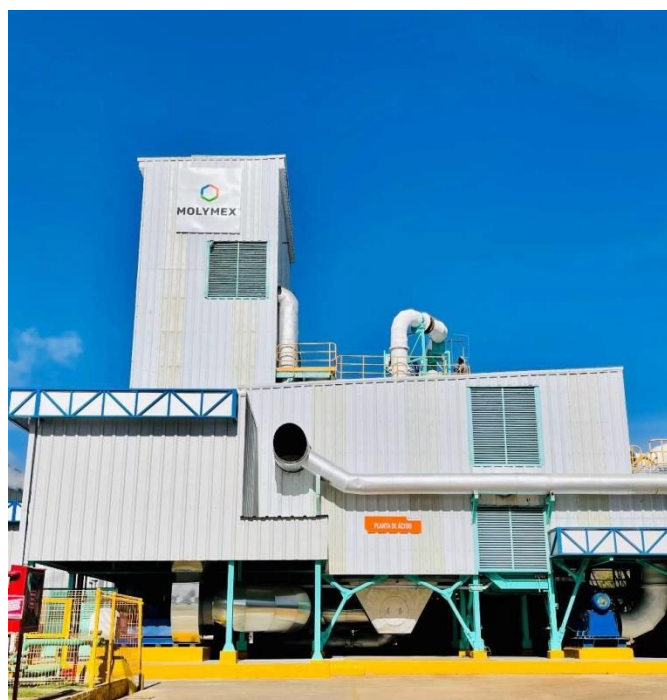
Planta de tratamiento de dióxido de azufre
