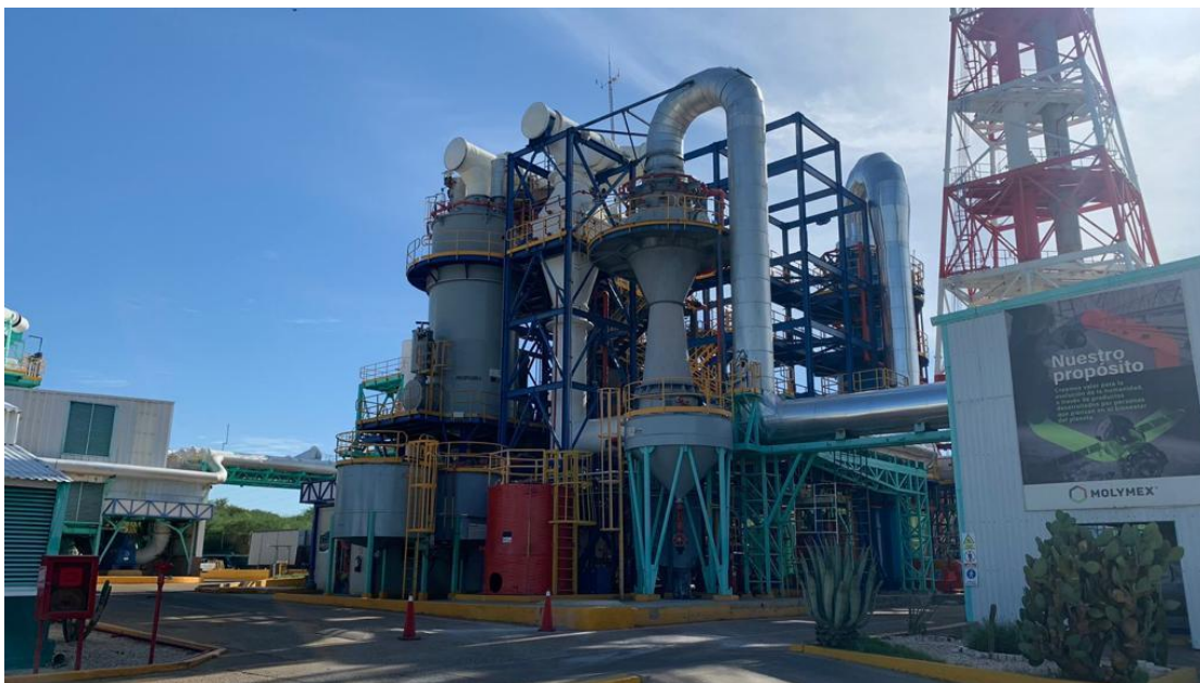
Planta de lavado de gases
