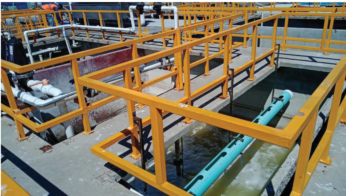
Foto No.12.- Foto tomada desde las pilas de tratamiento de la PTAR, vista de pila de clarificacion.
