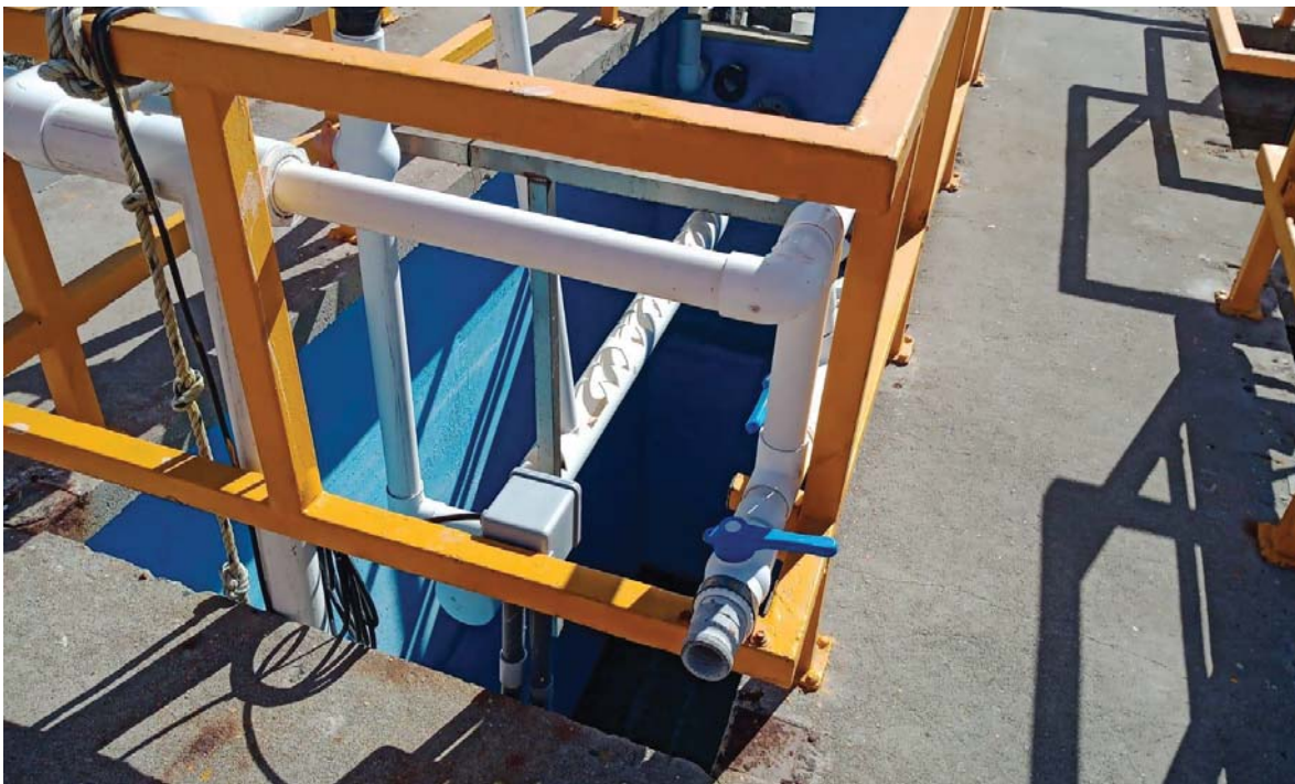
Fotografía II.6 Muestra tanque contacto cloración.
