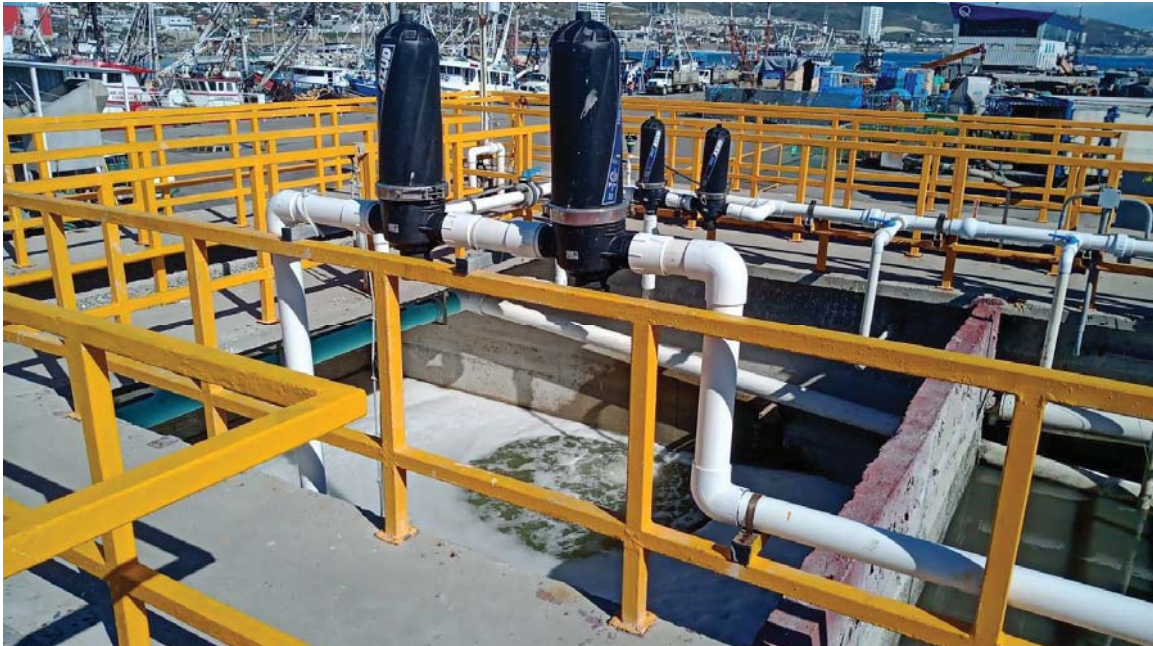
Foto No.10.- Foto tomada desde las pilas de tratamiento de la PTAR, vista en dirección NorEste, se observa Filtros clarificadores, al fondo Puerto Sauzal.
