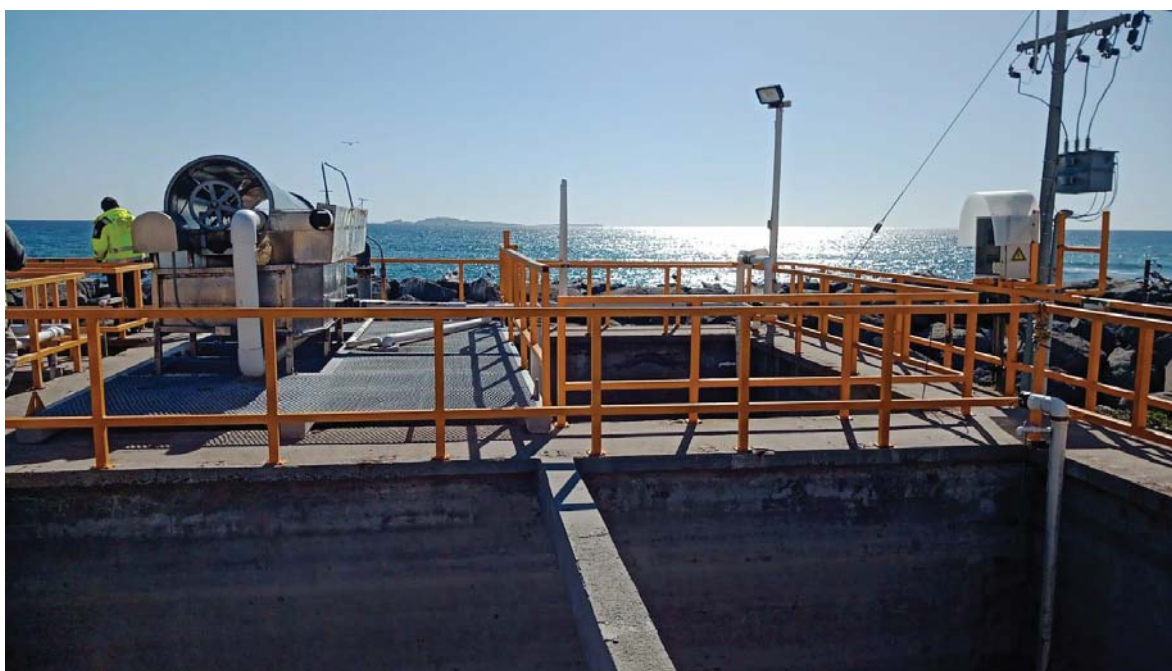
Fotografía II.4 Muestra en su margen izquierdo la unidad conocida como Roto criba la cual está sobre uno de los tanques de reacción estabilización pH.
