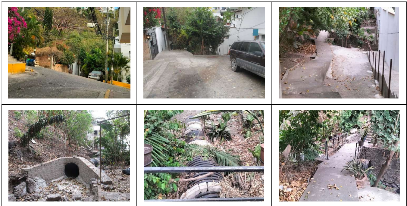
Figura 19. Estado actual del acceso por calle Olas Altas e infraestructura del canal.
