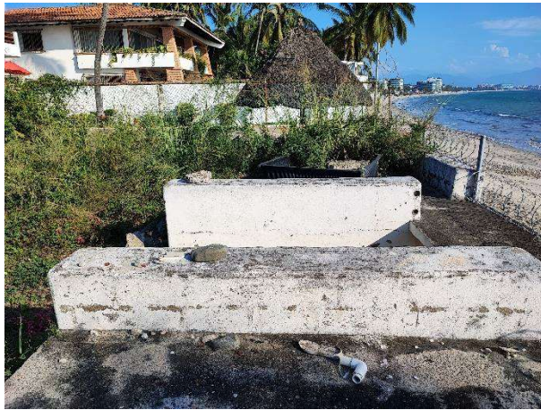
Imagen 15.- Vista hacia este desde interior de superficie de Zona Federal Marítimo Terrestre, obras existentes. mismas que no fueron construidas por el mismo
