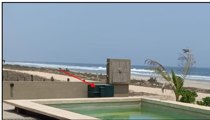
Fotografía 51. Transformador de pedestal.
