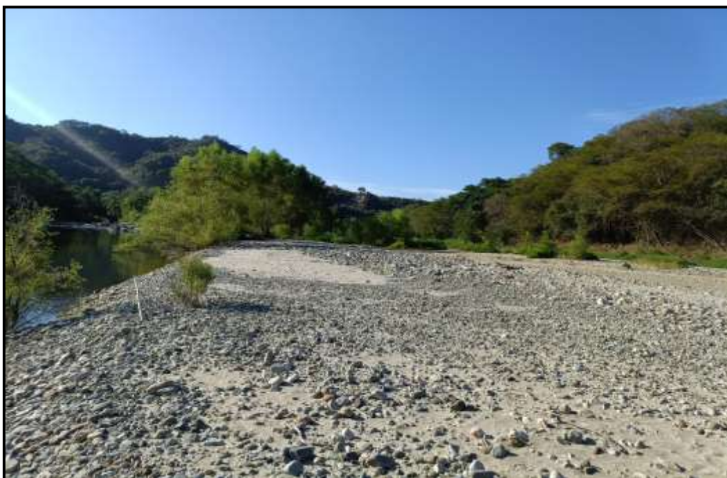
Fotografía 12. Existe acumulación de material pétreo, lo que requiere del desazolve del río y evitar así inundaciones a terrenos de uso agrícola aledaños.
