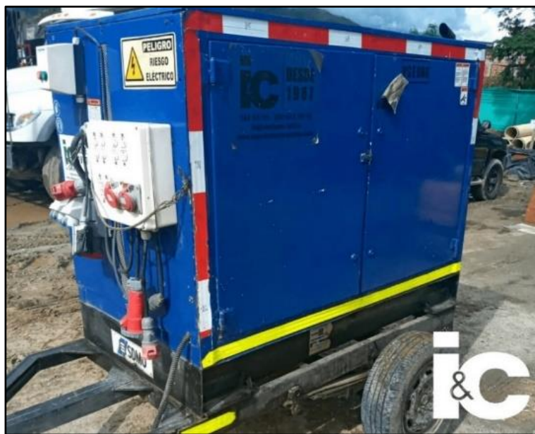
Figura II-7. Ejemplo de Planta generadora de energía de renta en el mercado (Fotografía obtenida de Ingeniería & Contratos S.A.S, 2025).
