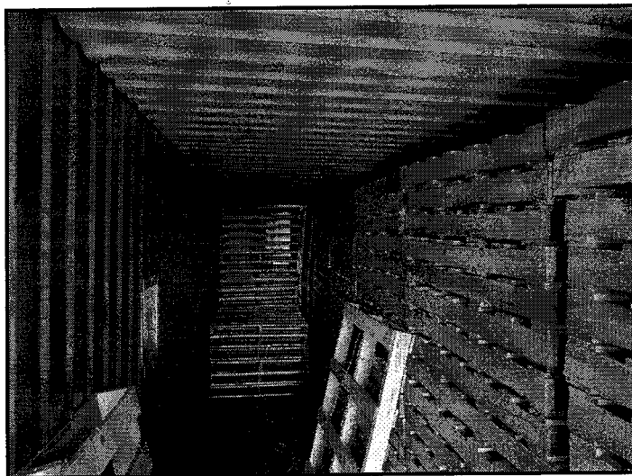
Interior de la cámara de tratamiento
