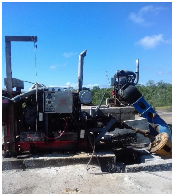
Figura II.4.- Cárcamo de bombeo de la granja Zaratajoa Produce S.A. de C.V.
