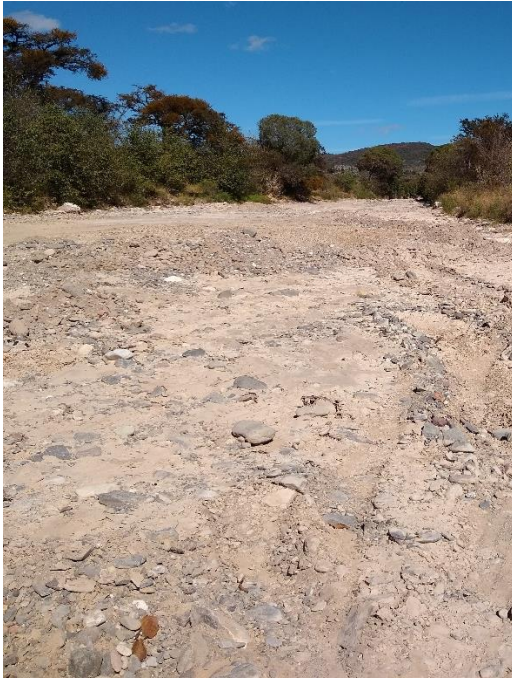
Fotografía 5. Condiciones actuales banco 1.
