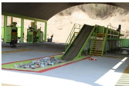
Planta de separación y compactación de plásticos
