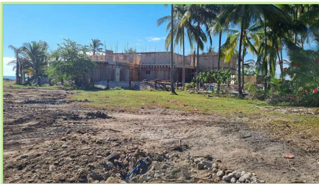
Imagen IV.2. Obras existentes entre el polígono del proyecto y el escurrimiento donde se pueden observar las huellas de maquinaria en el polígono de nuestro proyecto que lo utilizan como pasadera o tránsito de la obra colindante en construcción.
